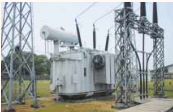
本事業により設置された変圧器
