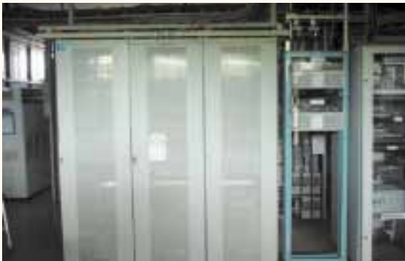
本事業により整備された光伝送路システム
