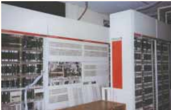
本事業により設置された交換機施設
