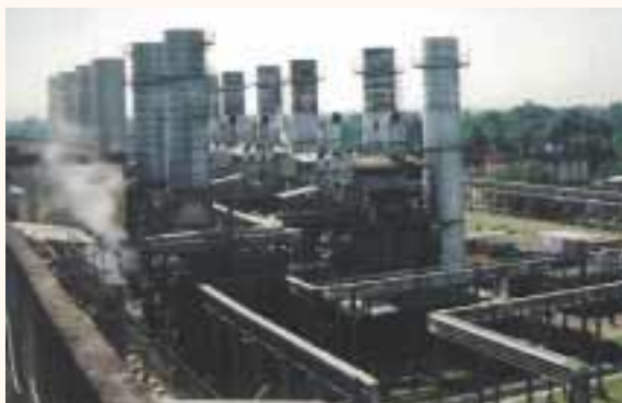
本事業により建設されたアッサムガスタービン発電所
