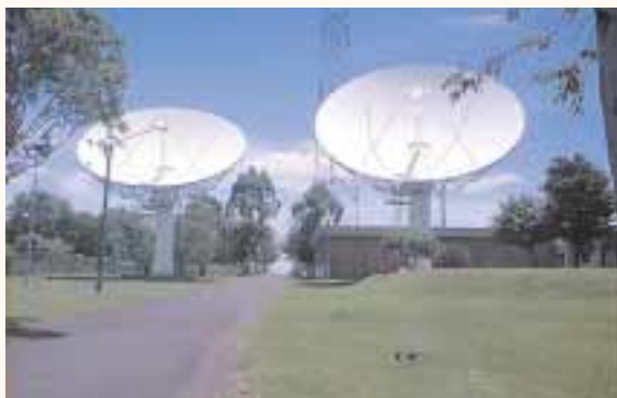
本事業により設置されたパラボラアンテナ
