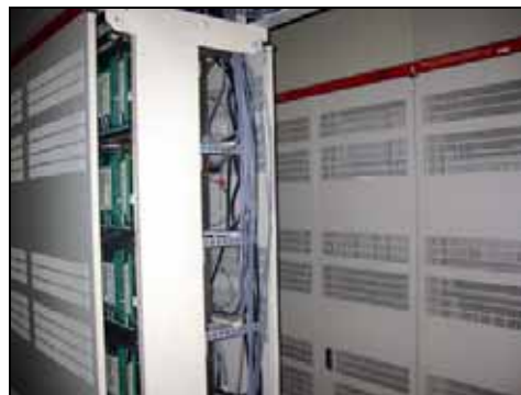
本事業により調達された交換機
