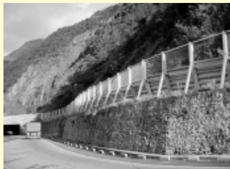
落石防護フェンスが張られたロザリオ-プゴ-バギオ道路
