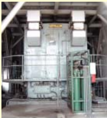
本事業で調達された発電機
