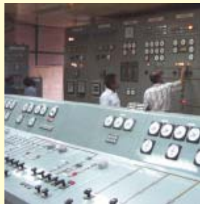
発電機のコントロールルーム
