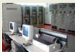
変電所内管理制御室
