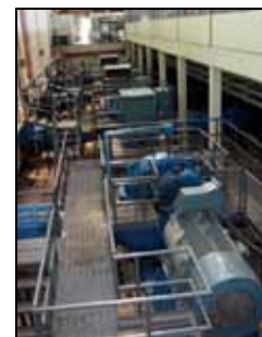
図 6 ラッカバンポンプ場
