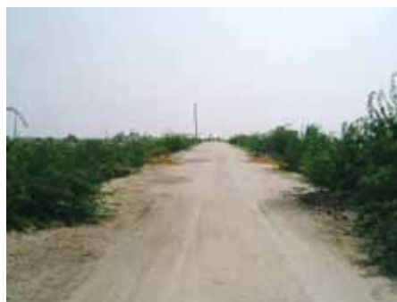
改良前の道路
