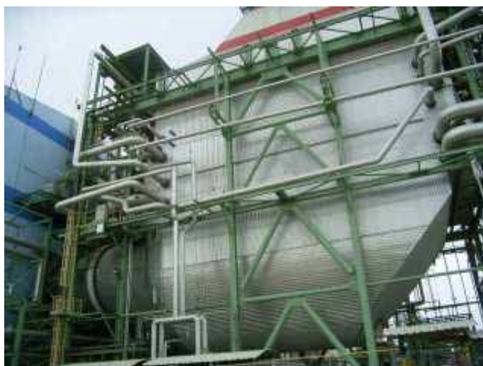
(新設された火力複合発電所 = バクー郊外で)
