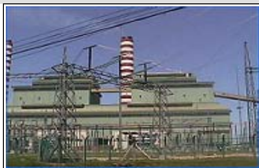
ポートクラン火力発電所 (カパール・フェーズ 3)
