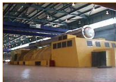
図4 本事業で設置された蒸気タービン
