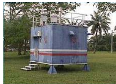
図 12 大気汚染物質測定設備
