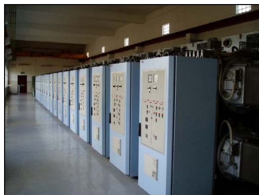
本事業で建設された開閉設備
