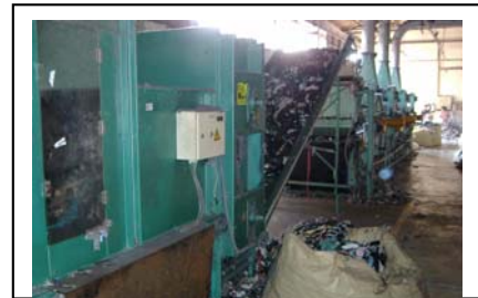
図1 端切れフェルトの再生設備
