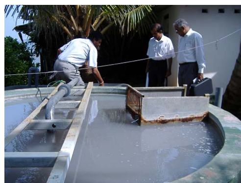
本事業によって導入された廃水処理施設
