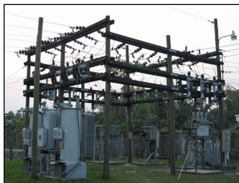
本事業により建設された変電所
