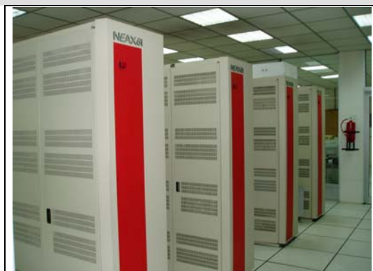
イスラマバード国際交換局設備
