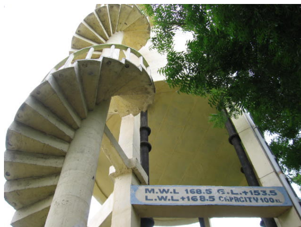
配水タンク (ティルパティ市)
