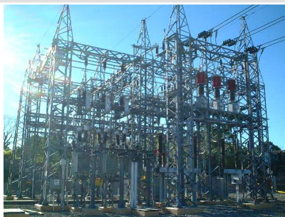
サント・トマス変電所
