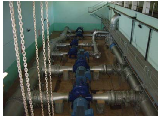
ロマピタ配水センターの配水ポンプ
