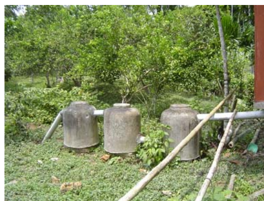
図-7 簡易トイレの汚水処理施設 (ロレト県)
