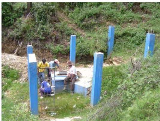
図-14 上水道取水口
