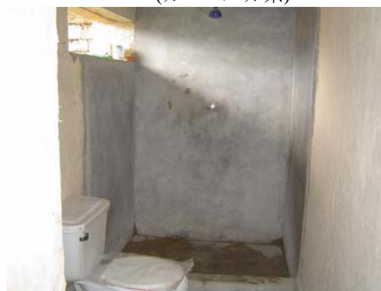
図-5 水洗トイレとシャワー (カハマルカ県)
