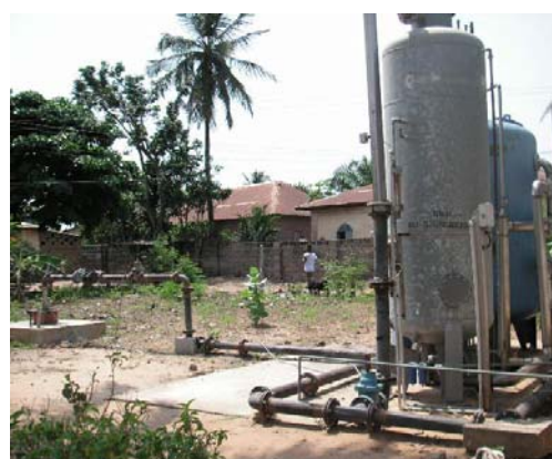
図 1 取水井戸ポンプおよび浄水設備 ボルタ地域(デヌ)
