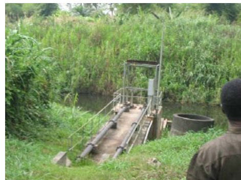
図3 川からの取水設備 ボルタ地域（ホホエ）
