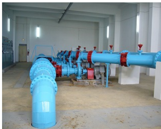
配水施設の上水供給パイプ
