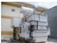
本事業実施によりコロombo変電所に設置された変圧器
