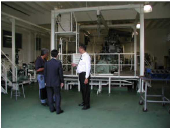
航海学校：機関演習施設
