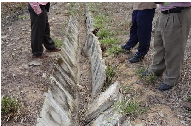
コンクリート板が崩落した水路の状況
