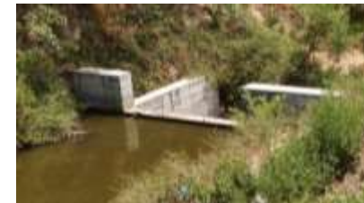
ヒマーチャル州で建設された灌漑施設
