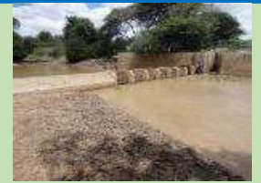
角落しによる取水堰
