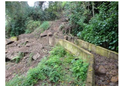
洪水による土砂で埋まった水路
