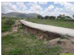
劣悪な水路施工
