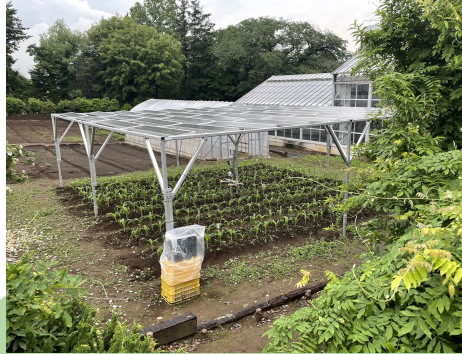
発電装置(パネル・架台)
