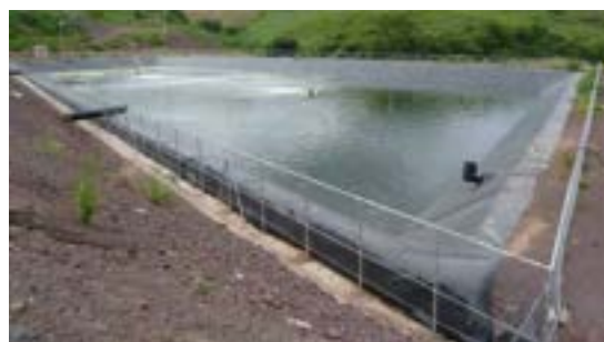
写真 7-19 浸出水貯水池でのエアレーター 使用の様子
