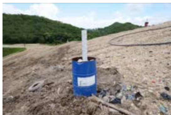
写真 7-39 設置されているガス抜き管
