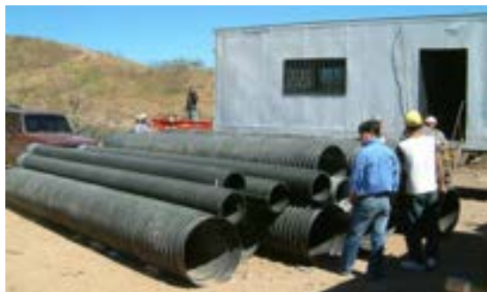
写真 7-16 使用された浸出水集水管
