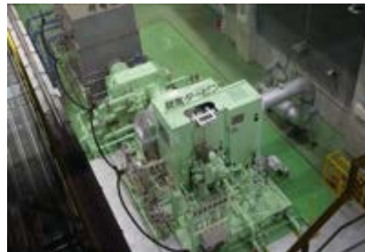
写真 4-43 蒸気タービン（杉並清掃工場）
