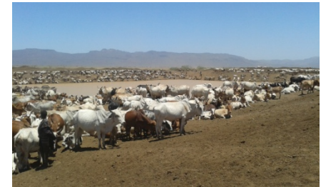
本プロジェクトで建設したため池。乾季には水を求めて1万頭以上の家畜が集まり、その周辺の牧草を消費する。
