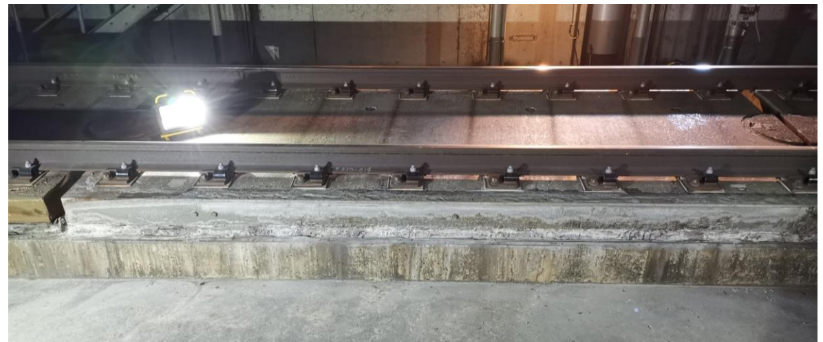
端部の凍害による断面欠損（時間短縮と高品質を両立）
