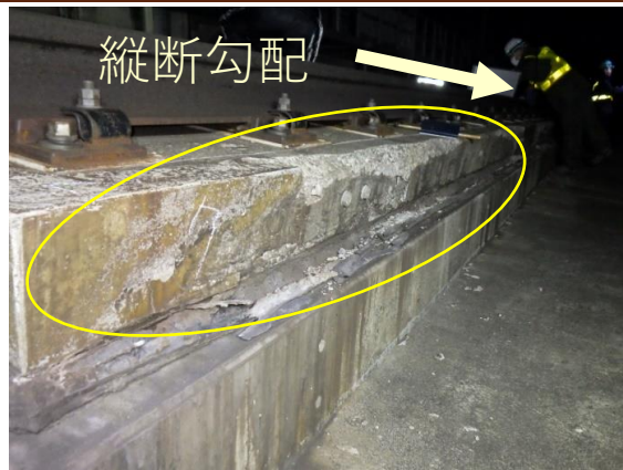
端部の凍害による断面欠損
