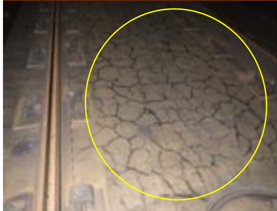
2方向のひび割れ
