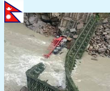
ベイリー橋の崩落事故例
