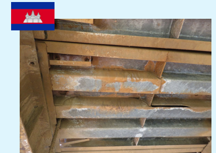
ベイリー橋床版の損傷事例
