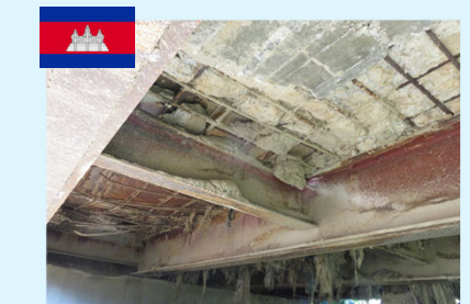
鋼橋床版の損傷事例
