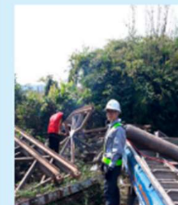
ラオスにて、研究活動の一環として実施した仮設橋の部材強度の確認作業を行うタボン博士（写真：長崎大学）
