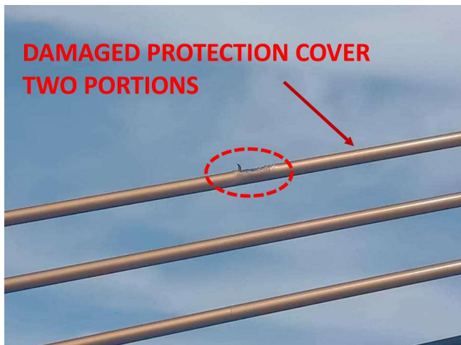
ケーブル損傷
