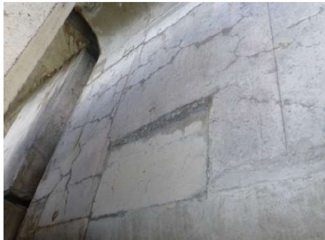
ASR状況(PC主桁部)
