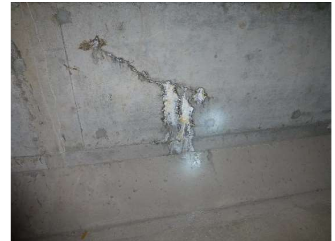
PC箱桁内のクラック
