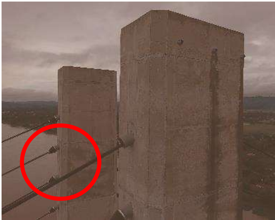
脱落した止水ゴムカバー
