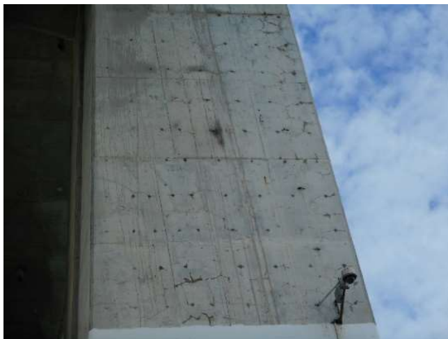
ASR状況(主塔橋脚部)
