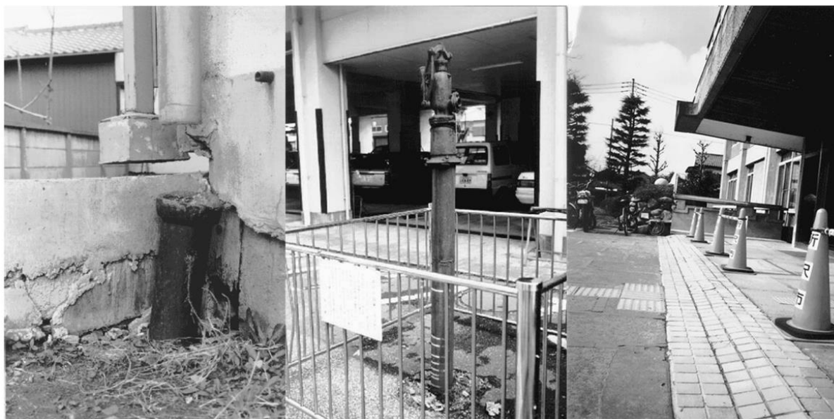
千葉県浦安市の被害事例:建物の拔 上がり状況
