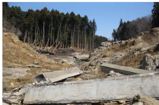
資料：福島県須賀川市藤沼決壊について 東北大学による 東日本大震災1か月後緊急報告会
