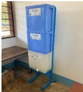
タンザニアの保健医療施設に設置された飲料水用浄水システム
