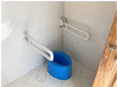
タンザニアの学校に設置されたバリアフリートイレに設置された SATO の洋式便座
