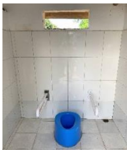
SATOの洋式便座が設置された障がい者用トイレの内部（タンザニアの保健医療施設）
