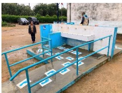
マダガスカルの学校に設置されたグループ手洗い施設と足跡の絵
