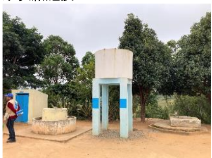
マダガスカルの学校に建設された高架水槽
