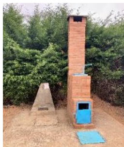
マダガスカル保健医療施設に建設された焼却炉と手洗い用蛇口
