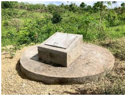
タンザニアの保健医療施設に建設されたプラセンタピット
