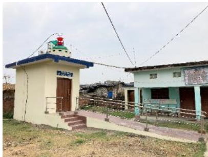
ネパールの保健医療施設に新設された障がい者用トイレの上部に浄水システムが設置
