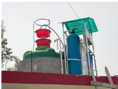
ネパールの学校に設置された飲料水用浄水システム
