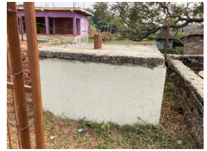
ネパールの保健医療施設に建設されたシャープピット
