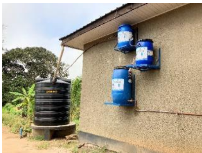
タンザニアの学校に設置された雨水貯留システムと飲料水用浄水システム
