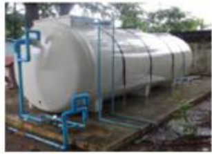
近畿地方173件 (例：滋賀県の浄化槽)
