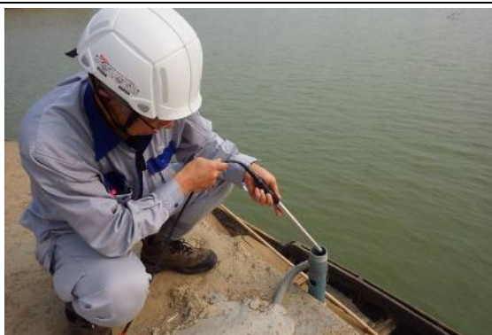
カナイガット Surma 橋水位計設置
