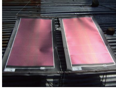
屋根の上のパネルの様子
