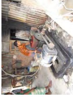
10kW ダイジェター発電機
