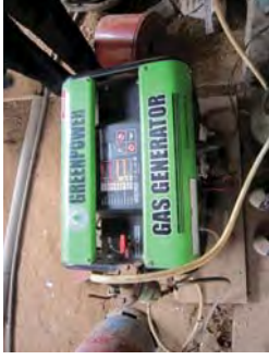
中国製ガスエンジン発電機
