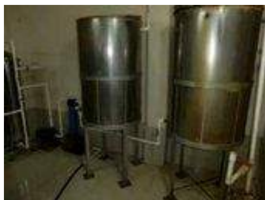
SK Fresh Mineral Water 工場内
