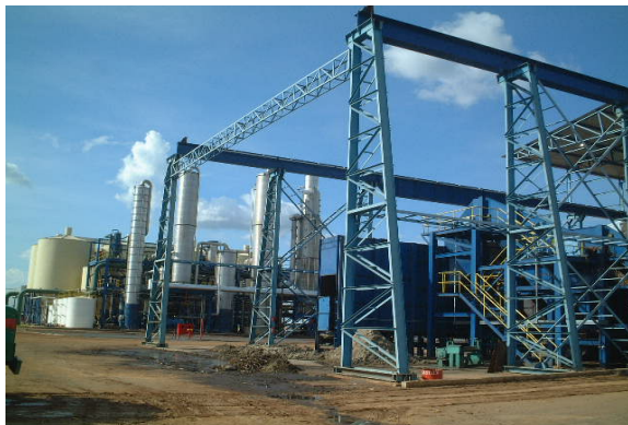
図 4 バイオエタノール精製工場
