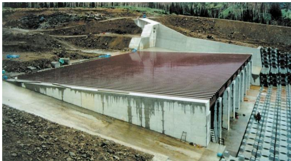
Figura 26. Exemplo de estrutura auxiliar para contenção de blocos de rocha e troncos
