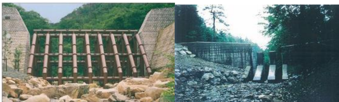
Figura 31. Exemplos de barragens Sabo permeáveis
