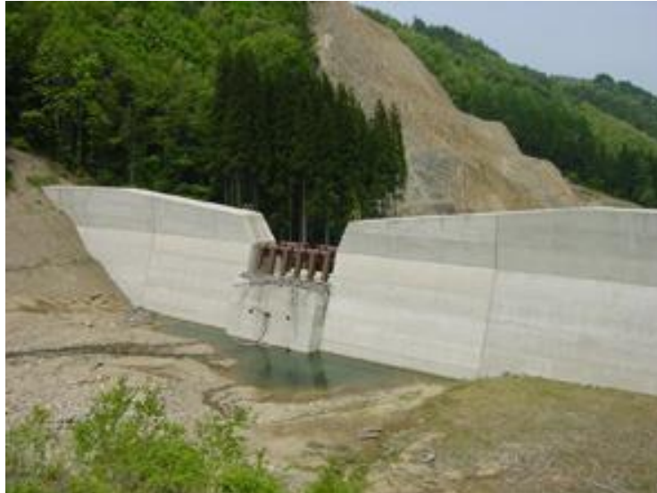
Figura 27. Exemplo de estrutura auxiliar para contenção de blocos de rocha e troncos
