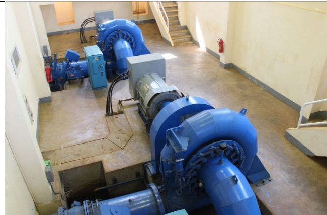
写真4：21年前に設置されたオチュム第2発電所の発電機。経年劣化に伴い機材が劣化、本事業によりこれら機器を取り換える予定。
