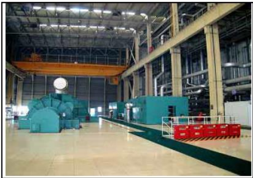
九江发电厂三期工程内部
