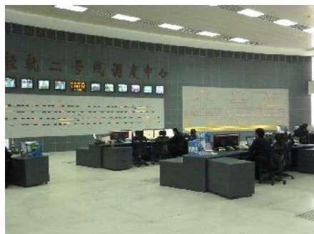
图10 运行安全生产调度中心
