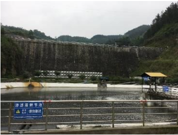
废弃物处理场的渗滤液处理设施
