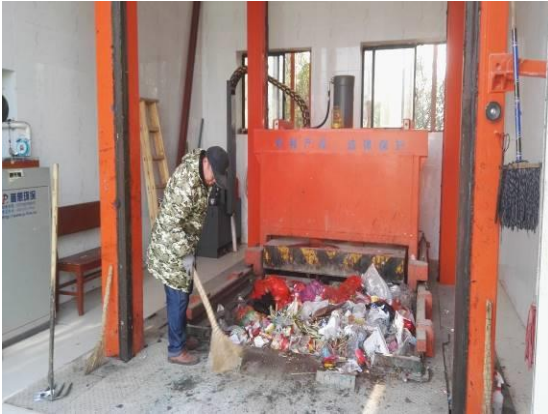
垃圾中转站垃圾处理实景 (临湘)
